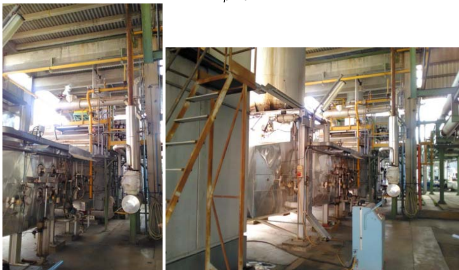
Immagine 1 – Canalizzazione fumi esausti e caldaia a recupero Impianto di Cogenerazione Stabilimento di Campoverde di Aprilia
