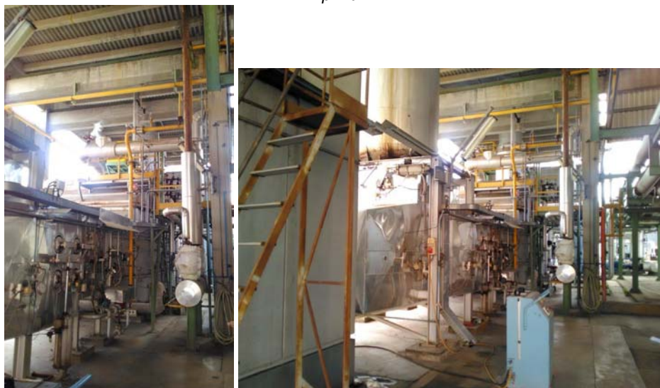
Immagine 1 – Canalizzazione fumi esausti e caldaia a recupero Impianto di Cogenerazione Stabilimento di Campoverde di Aprilia
